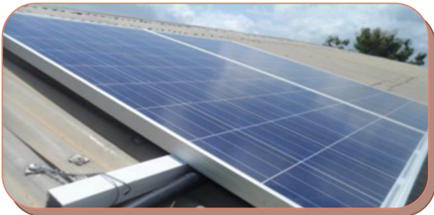
Les panneaux solaires installés
